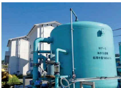
取水・ろ過施設
